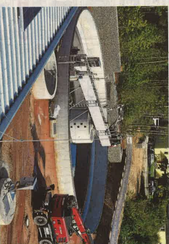
Eines der beiden Nachklärbecken der neuen Kläranlage: Hier durchläuft das Wasser den letzten Reinigungsschritt, bevor es in die Schwarzach geleitet wird.
